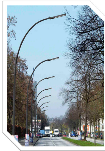
Straßenbeleuchtung mit Hilfe von Schaltsensoren
